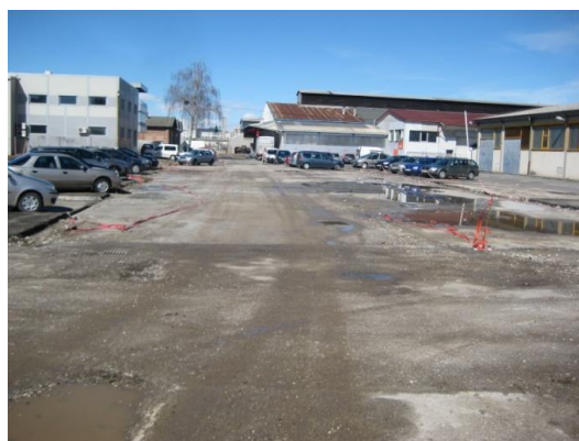
Stanje po rušitvi
