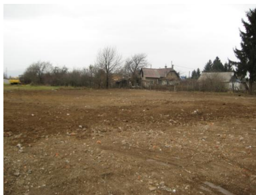
Stanje po rušitvi
